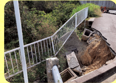
令和4年7月豪雨による市内の被害▲
