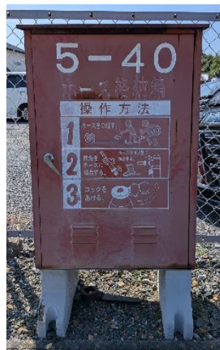
消火栓ホース格納箱
