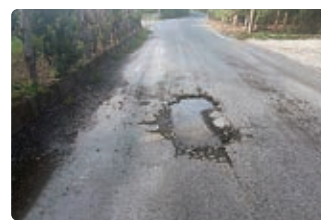
▲道路の穴・陥没
