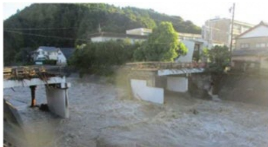
図 嘯月橋の一部損壊 (浜松市) 出典：国土交通省「台風15号による主な被害状況等について」
