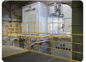
ろ過式集じん装置 (バグフィルタ) 排ガスに混ざっている灰を布製のフィルターで取り除き、きれいなガスにします。
