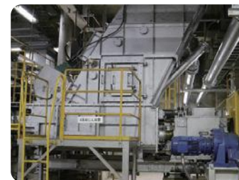
給じん装置 ごみ投入ホッパに入ったごみは給じん装置によって焼却炉へ送られます。
