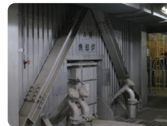
焼却炉 流動床式焼却炉といい、砂を巡回流動させることにより、安定した完全燃焼を行います。
