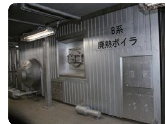
廃熱ボイラ 焼却炉から発生する熱で蒸気を作ります。蒸気は蒸気タービン発電機と隣接するアメニティプラザの温水プールなどで活用されます。
