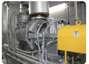
蒸気タービン発電機 廃熱ボイラで作られた蒸気で蒸気タービンを回して発電をします。発生した電気は施設内で利用しています。
