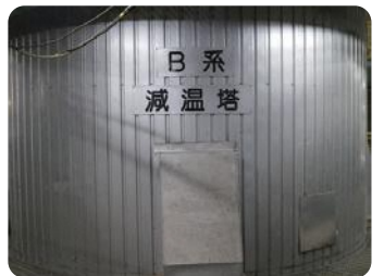
減温塔 廃熱ボイラを出た排ガスは減温塔で冷やされてろ過式集じん装置へ送られます。
