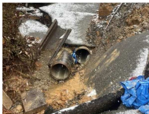
輪島市 送水管損傷
