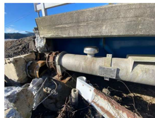
珠洲市 水管橋損傷
