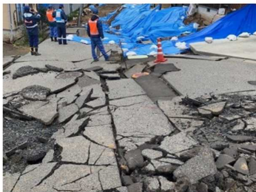
能登町 水道管損傷
