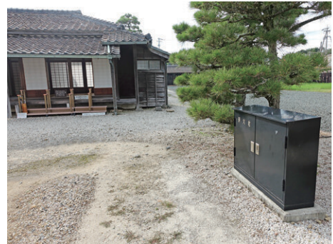
8- 4 新居関跡の消火栓
