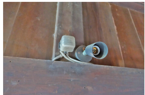
8- 5 新居関跡の老朽化した電気設備
