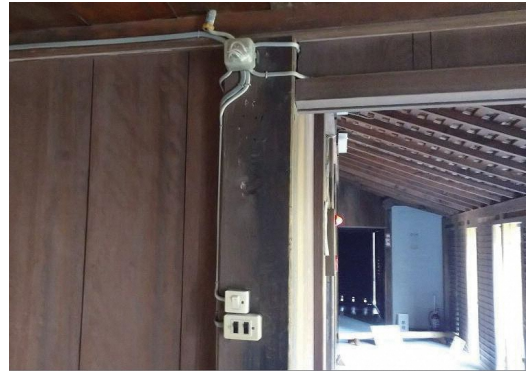
図4-16 老朽化した電気設備
