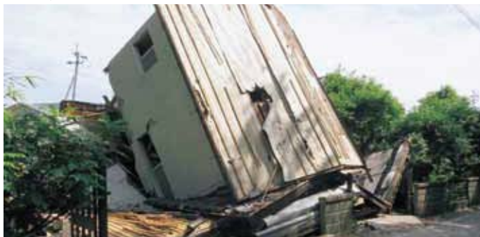
▼熊本地震での被害の様子
