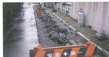
駿河湾を震源とする地震によるブロック塀の倒壊
