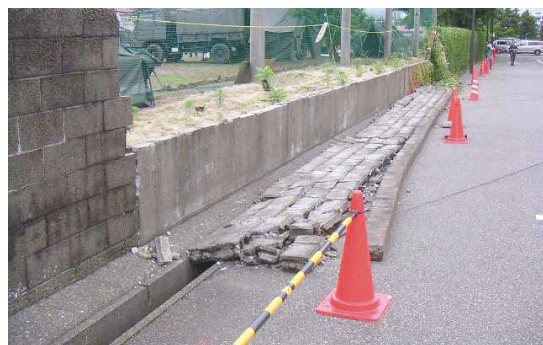
▲倒壊したブロック塀
