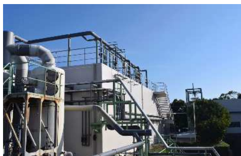
新たに機能が強化された処理水槽
